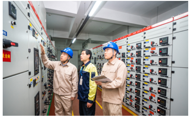
国网无锡供电公司员工检查朗新科技园电力设备情况
