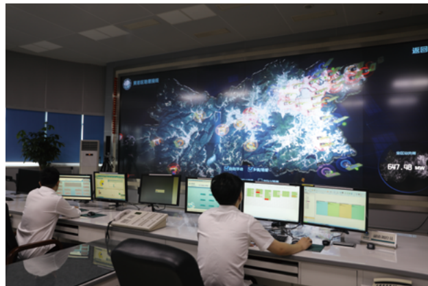
国网台州市黄岩区供电公司调度控制分中心人员 实时跟踪全区电网信息, 全力防御台风
