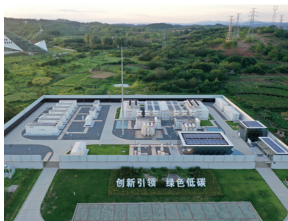
湖北广水100%新能源新型电力系统科技示范工程虎山能量路由器站
