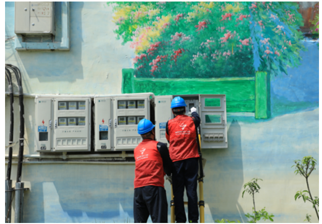
国网文成县供电公司员工检修民宿配电箱
