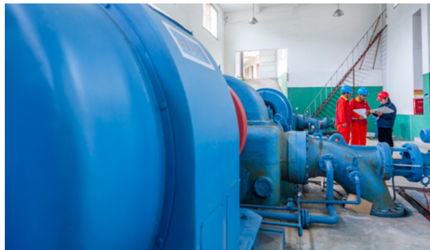
电力员工对大均乡均垟水电站开展安全隐患排查，保障水电站健康运行
